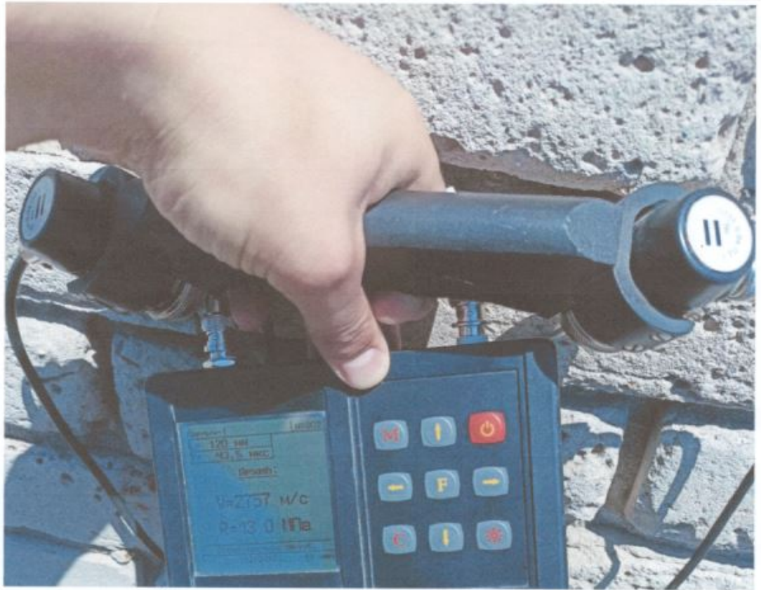
Фактическая прочность кирпичной кладки.
