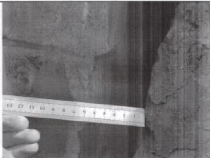
Ширина раскрытий трещин.
